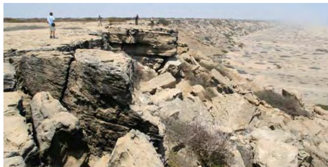
Fig. 3.32. Bloques derrumbados en el borde de abrasión marina cerca del puerto pesquero de La Tortuga
