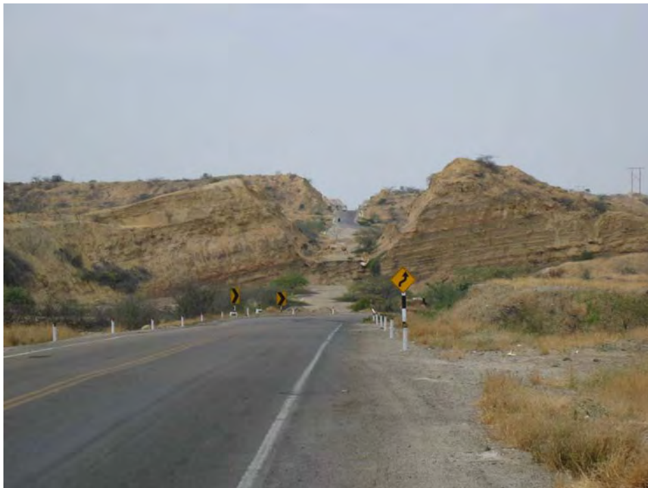
Fig. 6.5. Carretera destruida por un flujo torrencial en sedimentos terciarios finos-arenosos, que son fácilmente afectados por la erosión, carretera Panamericana de Sullana a Talara.
