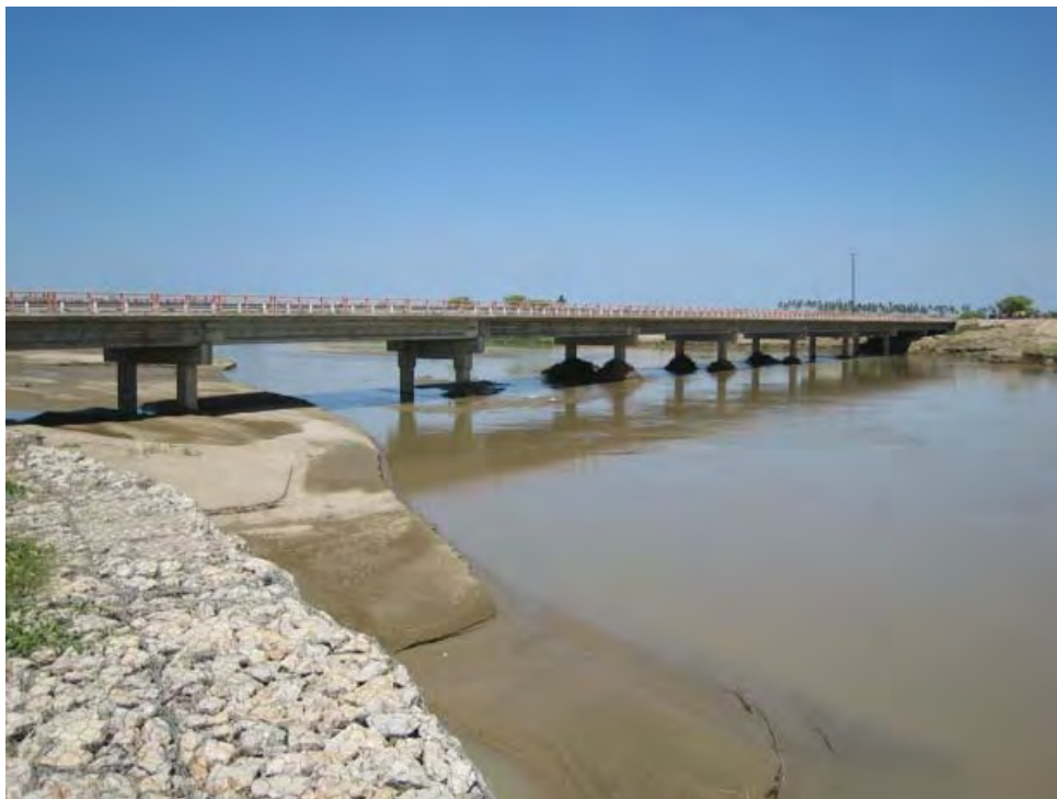
Fig. 6.11. Nuevas acumulaciones de sedimentos fluviales del Río Piura alrededor del puente Independencia al sur de la ciudad Piura.
