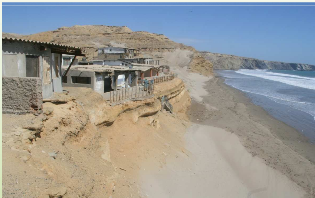
Los Cangrejos – amenaza de derrumbe de las casas por abrasión marina
