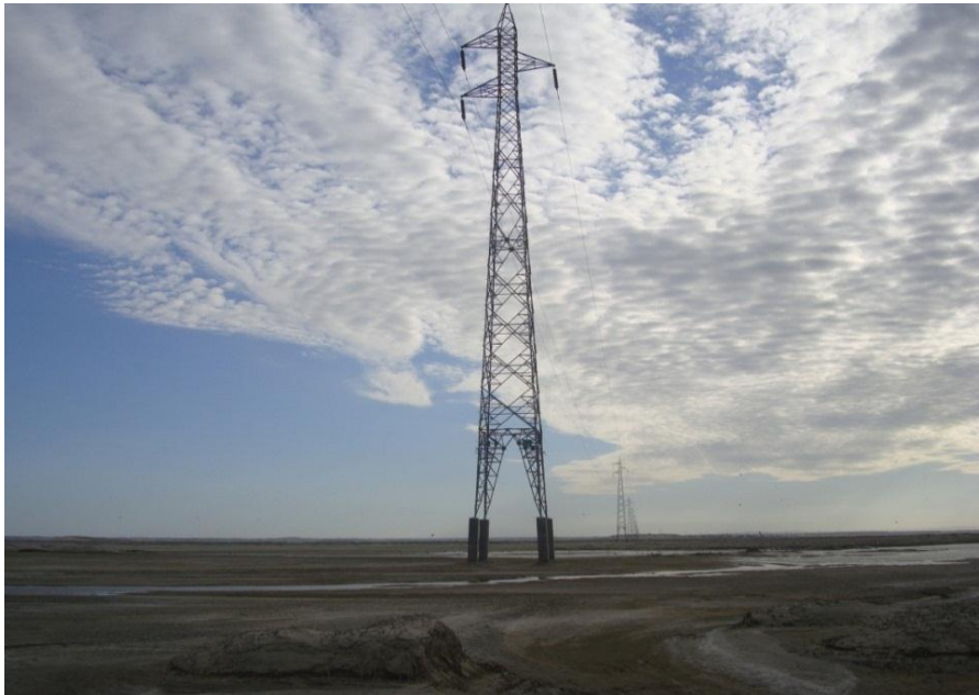
Fotografía 3.3.4-9. Vista a las torres de la línea de transmisión subestación laguna La Niña – Mina Bayóvar
