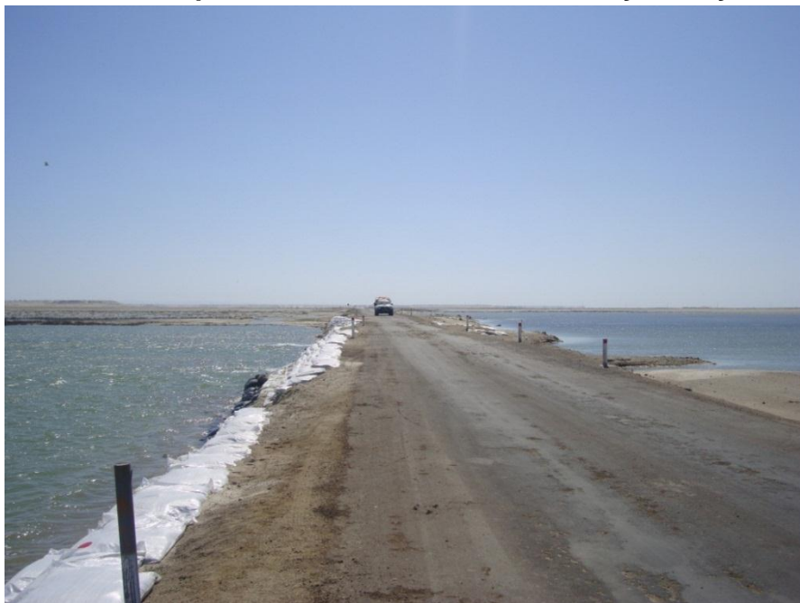
Fotografía 3.3.4-8. Vista que muestran los efectos de la laguna “La Niña “en la carretera que conduce de desvío a Chiclayo –Bayóvar
