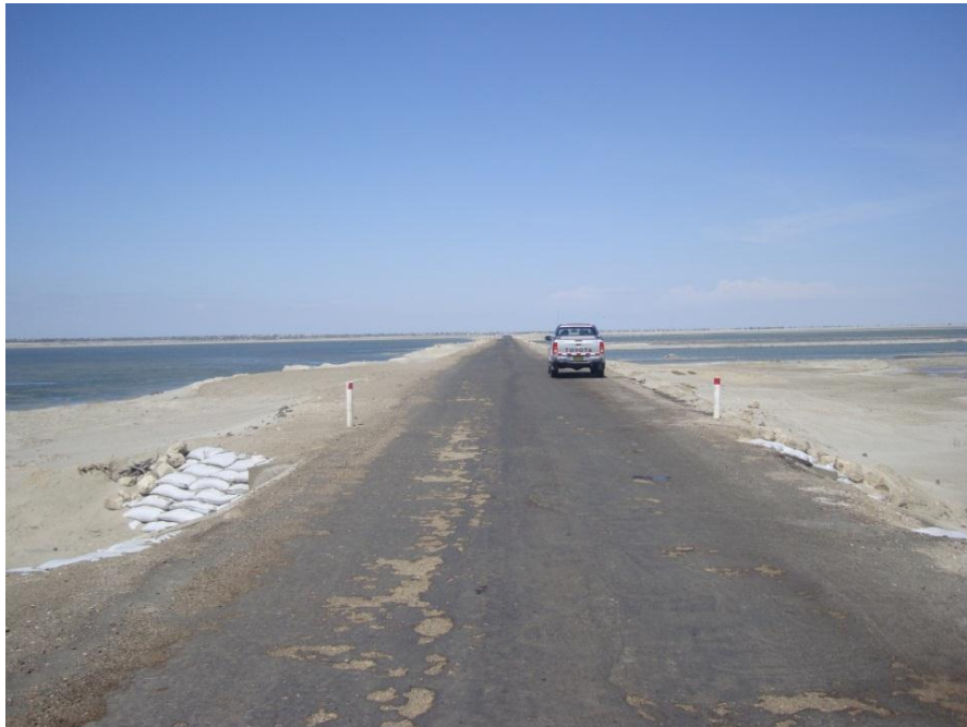
Fotografía 3.3.4-7. Vista que muestran los efectos de la laguna “La Niña “en la carretera que conduce de desvío a Chiclayo –Bayóvar
