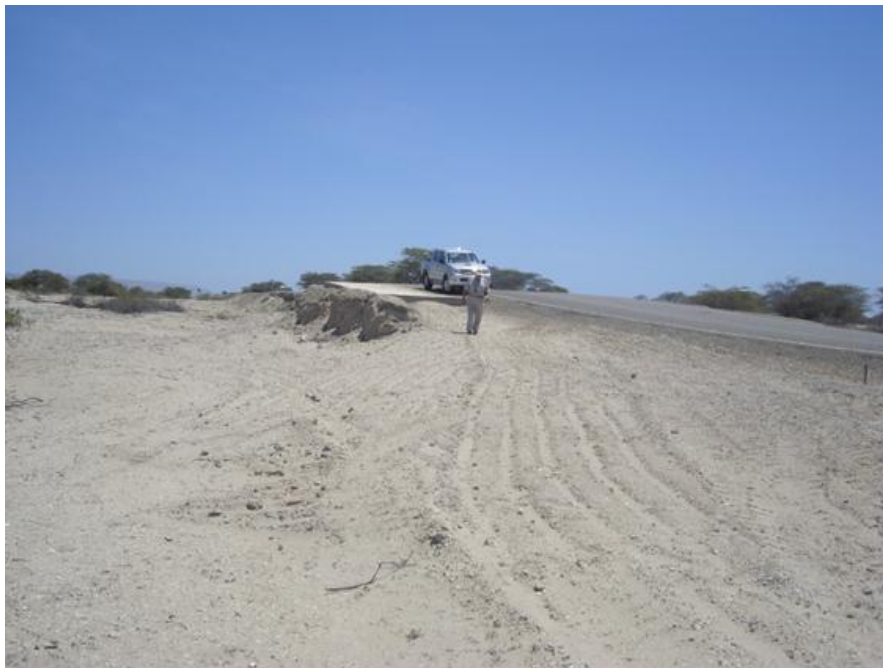
Fotografía 3.3.4-4. Vista a carretera Bapo – Desvió Chiclayo, erosionada por torrente que discurrió por lecho de quebrada en el Niño del 1997-98.
