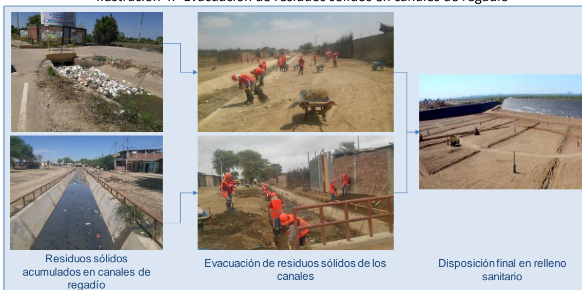
Ilustración 4.- Evacuación de residuos sólidos en canales de regadío
