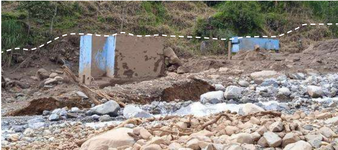
Figura 51. Caseta de distribución de agua potable ubicada en la margen derecha de la quebrada Pusmalca.
