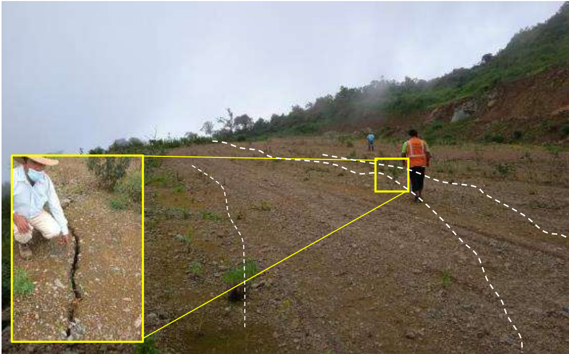
Figura 57. Vista de los agrietamientos observados en el DME-07.
