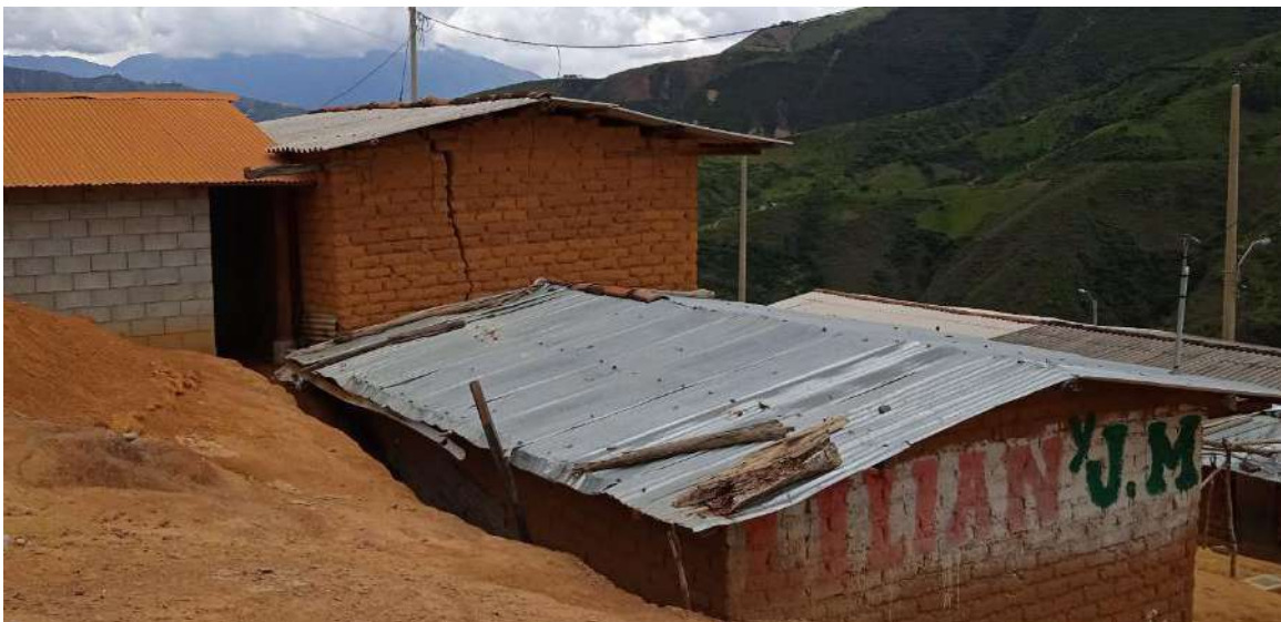
Figura 40. Vivienda afectada por asentamientos, coordenadas 9447385N y 647788E
