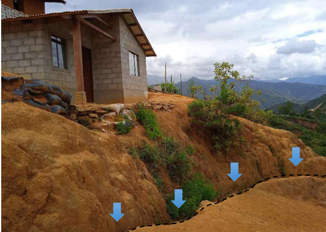
Figura 37. Zanja no revestida para drenar el agua de escorrentía en el AA.HH. Sagrado Corazón de Jesús, coordenadas 9447431N y 647787E.
