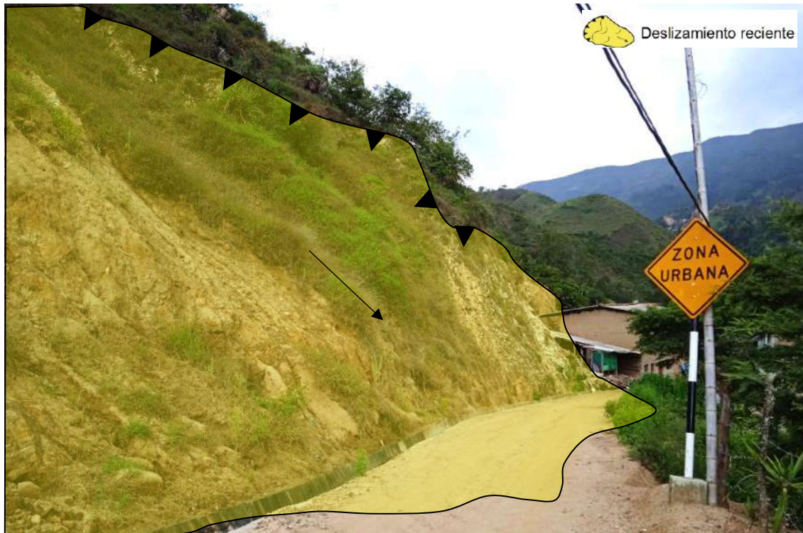
Figura 25. Escarpe principal del deslizamiento que afecta viviendas ubicada en la calle Villa Deportiva, coordenadas 9447863N y 647339E.
