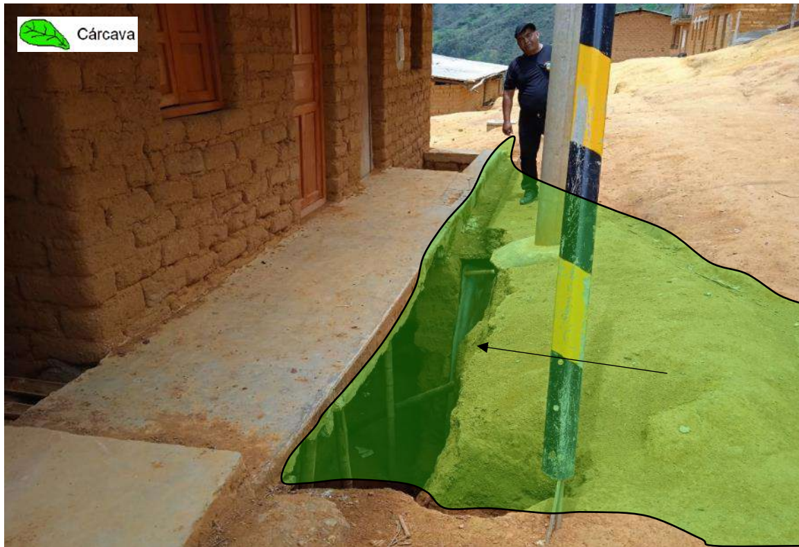
Figura 22. Vivienda afectada por procesos de erosión en las coordenadas 9447405N y 647751E.
