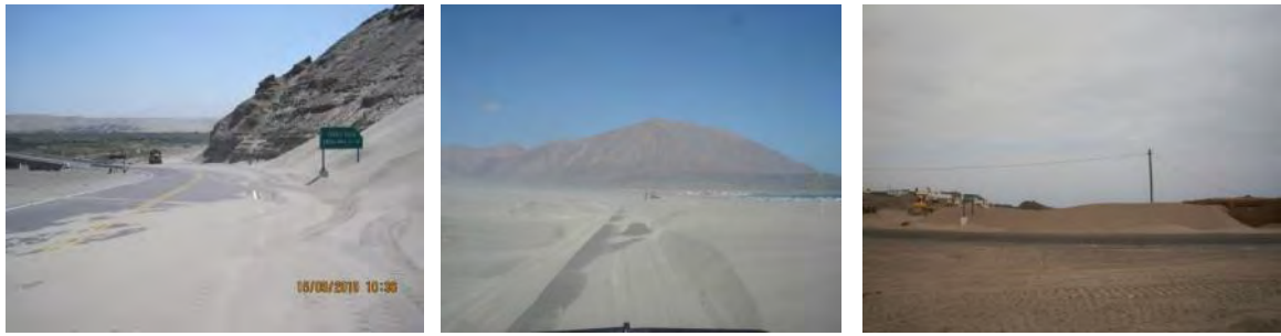
Fotos 2.32 – Estado de la carretera, antes de la intervención.
