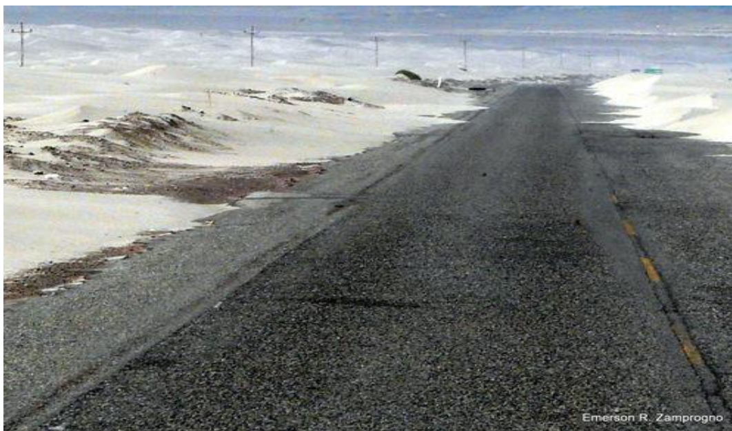
Foto 1.2 – Arenamiento en bermas y carpeta. Estado de carpeta deteriorada por la arena.
