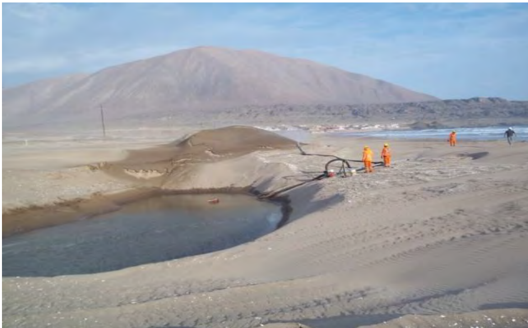
Foto 2.14 – Pozo para captación de agua
