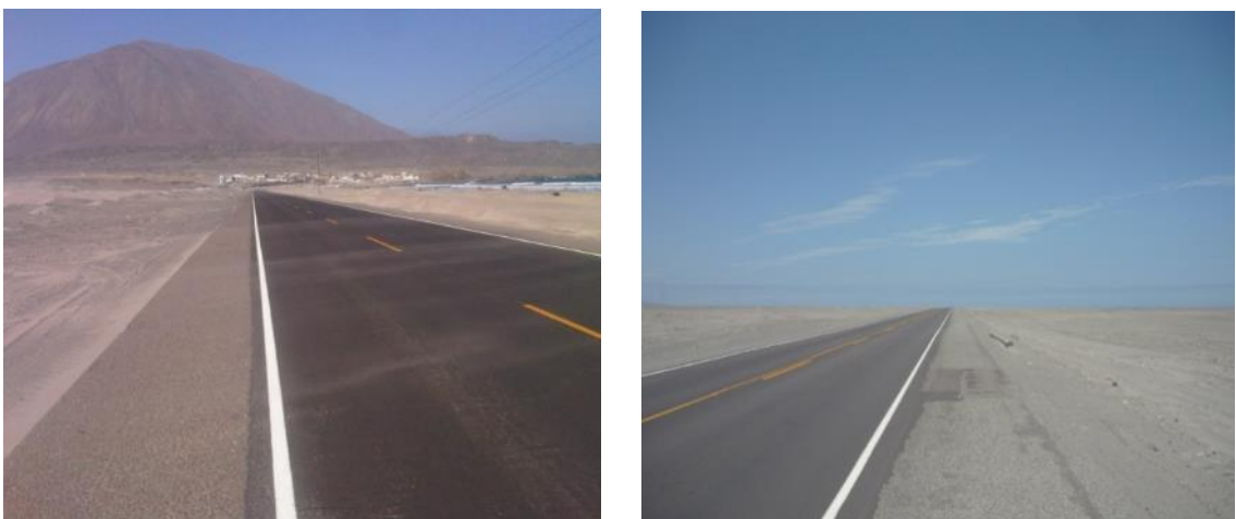
Foto 3.14 – Estado actual de la carretera en el sector de Tanaka
