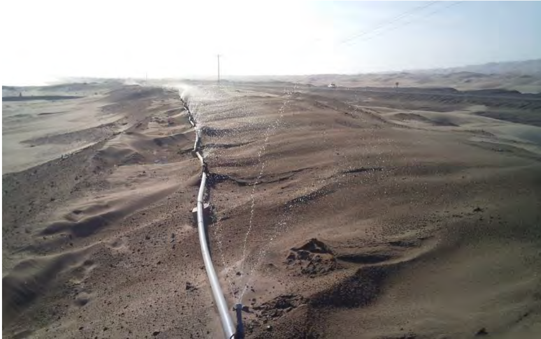
Foto 2.11 Riego por aspersión con agua de mar en domo
