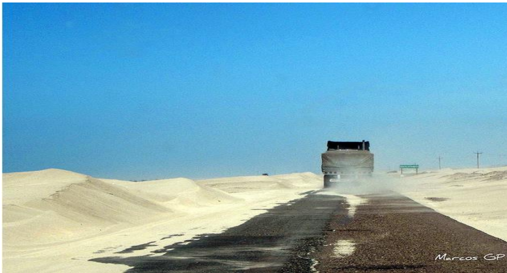
Foto 3.1 – Carpeta y bermas con arena por limitado mantenimiento
