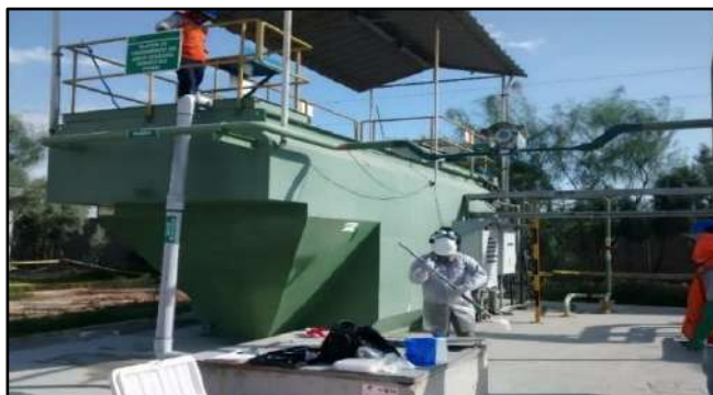
Figura 32. Planta de tratamiento de aguas residuales Fuente: Elaboración propia
