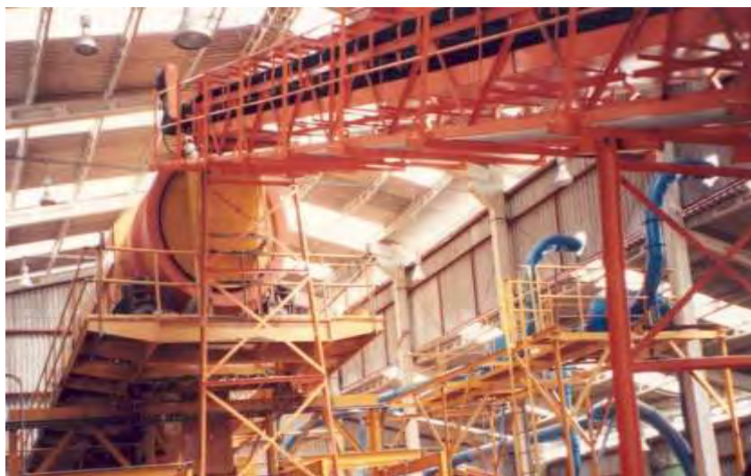
Figura 15 Planta se segregación mecanizada
