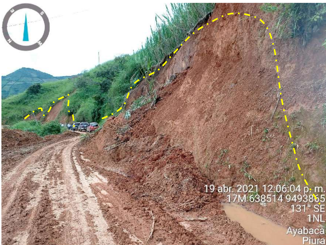
Figura 8: Deslizamientos en los taludes ubicados en las inmediaciones del sector Linderos, los materiales removidos se encuentran sobre la vía asfaltada.
