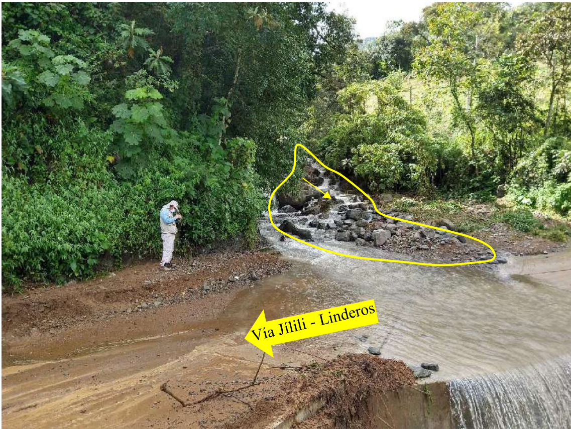
Figura 16: Materiales transportados a través del cauce de la quebrada Jilili, zona susceptible a la ocurrencia de flujos de detritos que podrían afectar la vía Jilili - Linderos
