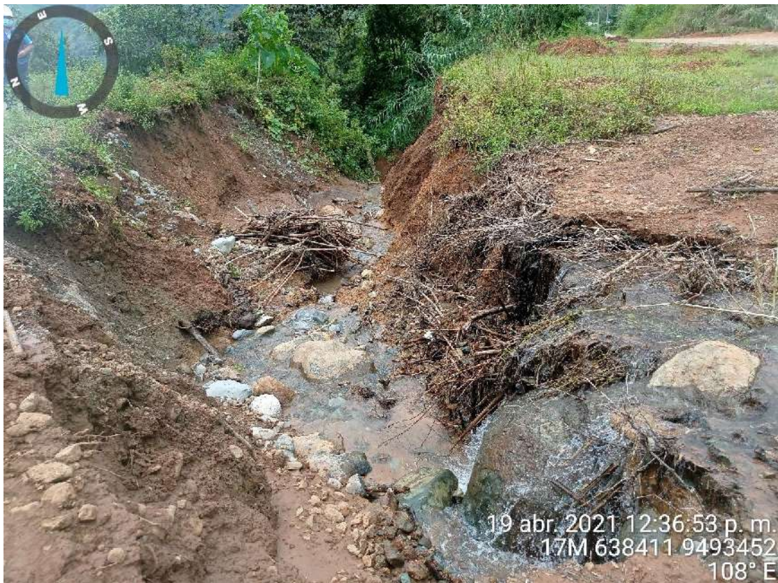
Figura 14: Erosión fluvial en cauce que drena sus aguas a la quebrada Linderos
